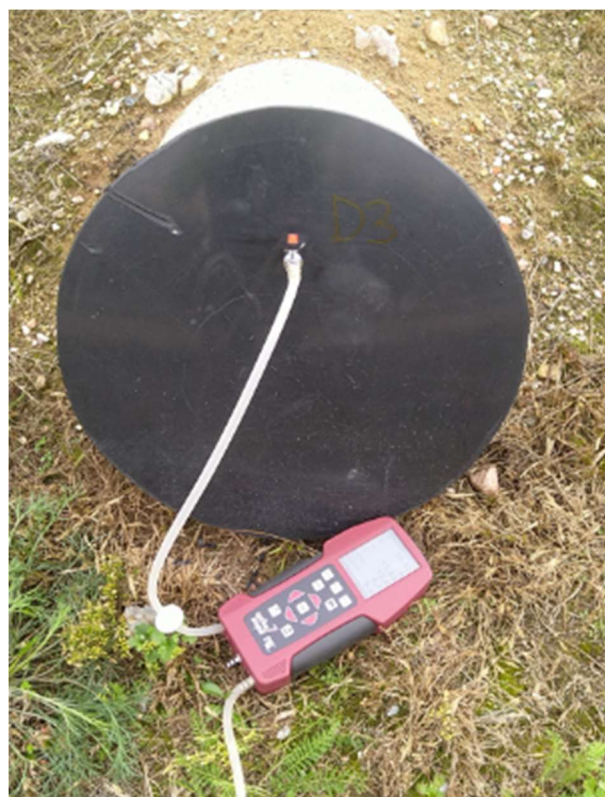
Fot. 6 Pomiar parametrów gazu w czyszczaku D-3
