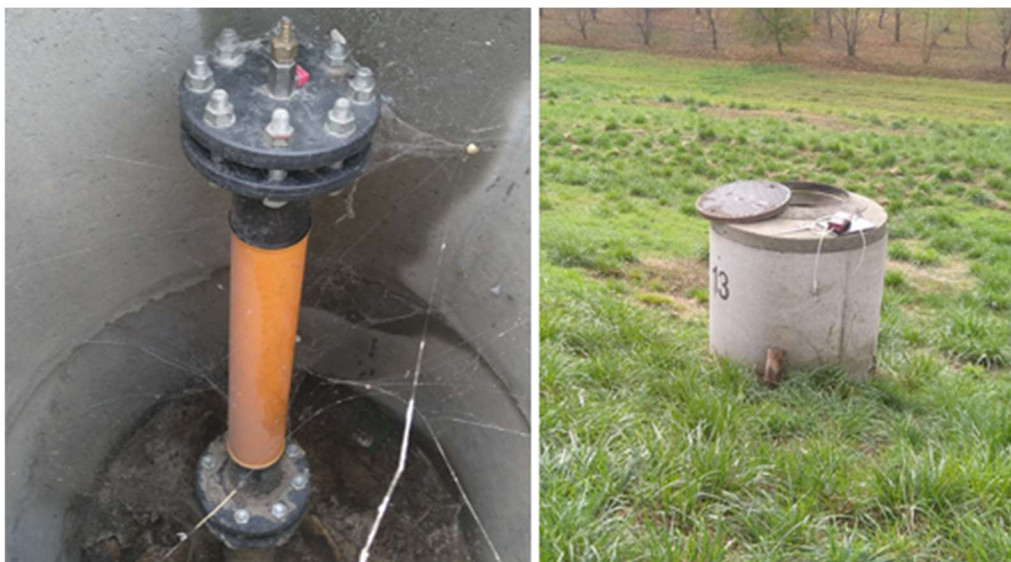
Fot. 21 Pomiary parametrów gazu w studni gazowej S-13
