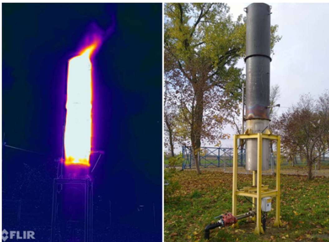
Fot. 16 Pochodnia spalająca gaz z zamkniętych kwater
