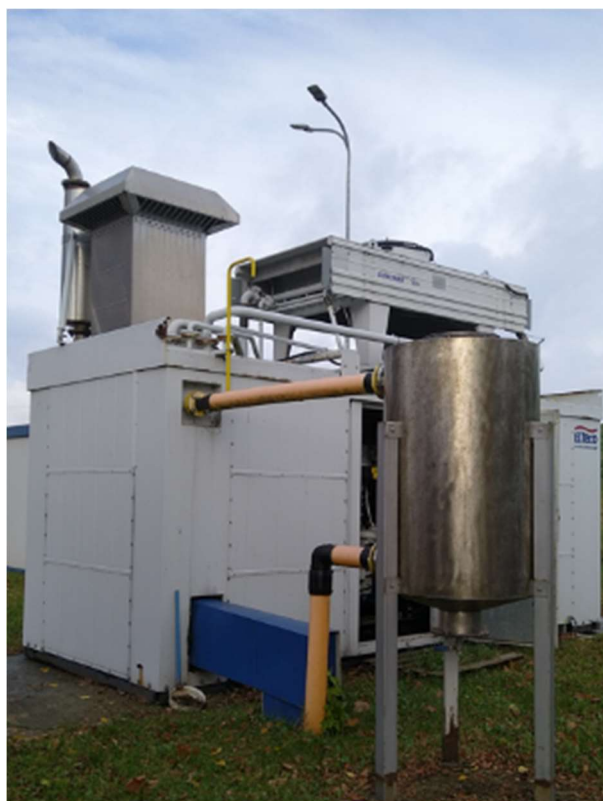
Fot. 19 Agregat kogeneracyjny z odsiarczalnikiem
