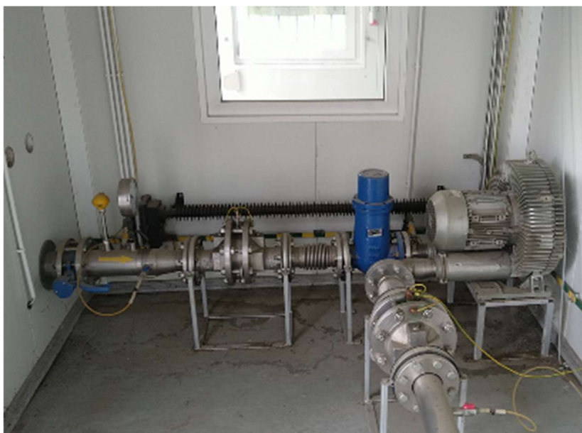
Fot. 18 Wnętrze stacji ssawy
