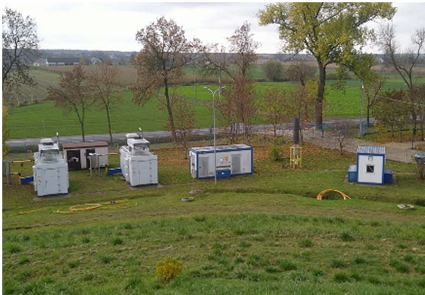
Fot. 14 Widok na urządzenia do utylizacji gazu
