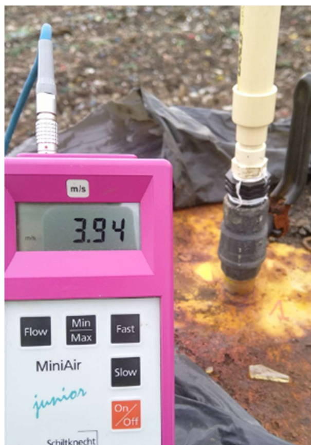
Fot. 8 Pomiar prędkości przepływu gazu w studni gazowej
