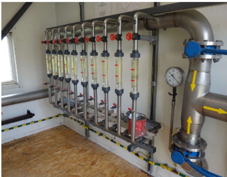
Fot. 17 Wnętrze stacji zbiorczej
