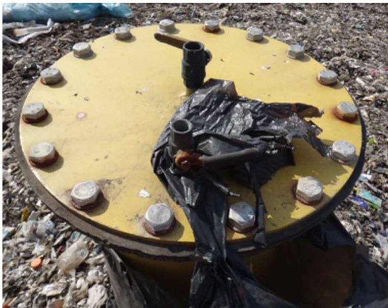
Fot. 1 Studnia gazowa na kwaterze 03
